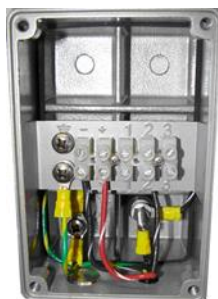
图 3-5 LX 膜堆接线盒内部
