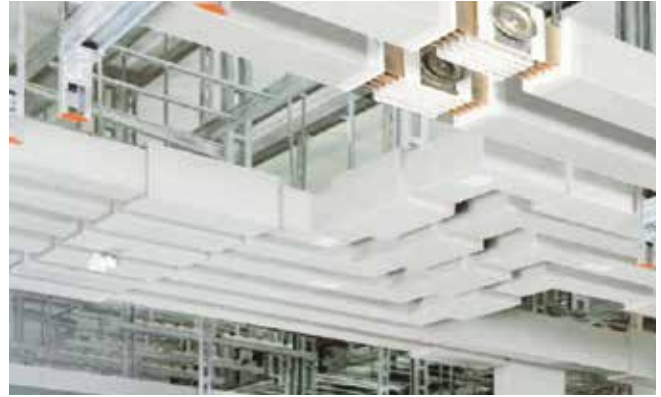
图1：LR浇注母线系统拥有IP68的超高防护等级，被广泛应用于造船、冶金、石油化工等各行业。
